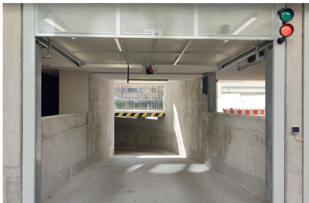
Contrôle d'accès évolutif. Seuls les étudiants qui ont loué une place de parking dans le garage souterrain sont autorisés, grâce à leur support d'identification, à ouvrir également la porte d'accès au garage souterrain. © CES
